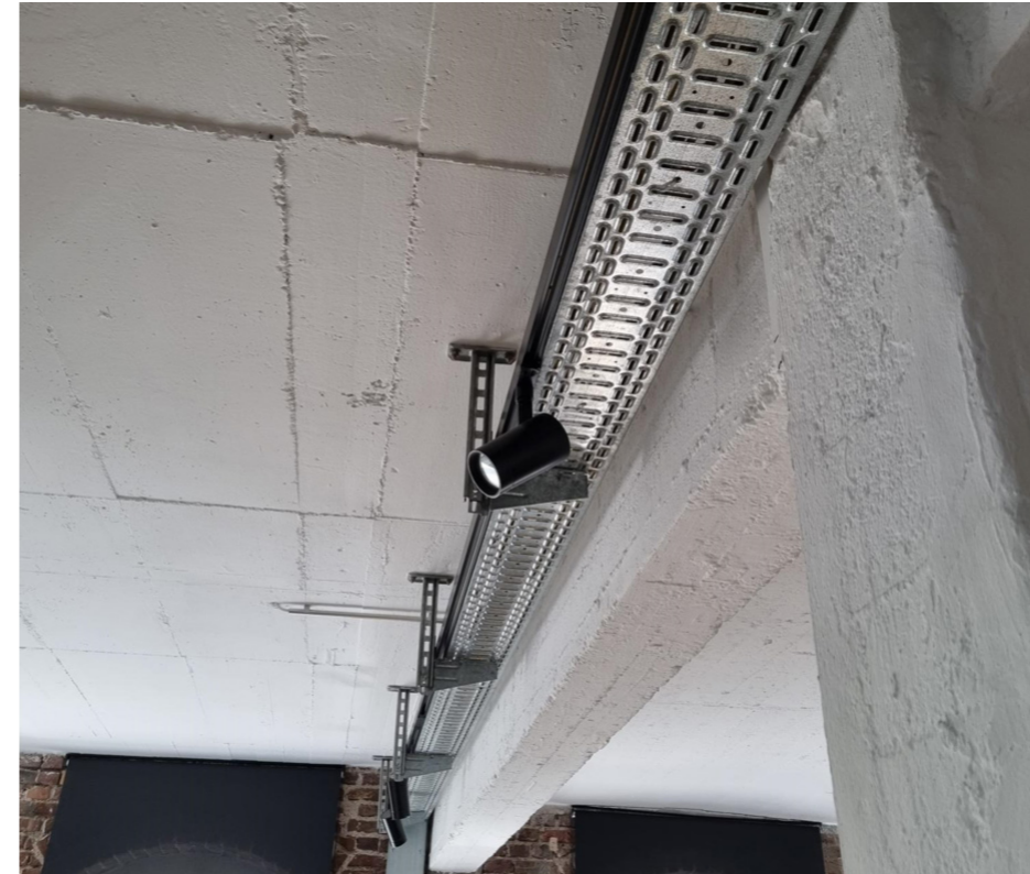
Nebentrasse mit zusätzliche Stromleiste a•g Licht
